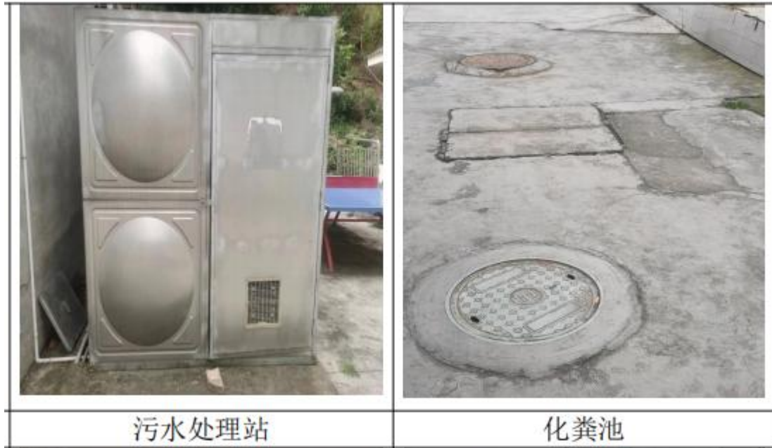
图 4-2 污水处理设施照片
